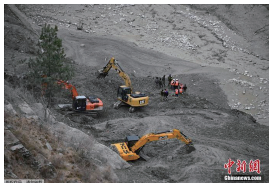
■ 图片来自中新网：印度北阿肯德邦溃坝事件现场，救援人员正在作业
